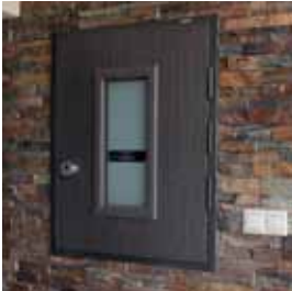
Absicherung eines Elektrizitätsmessers, Sicherheitsklasse 3 plus
